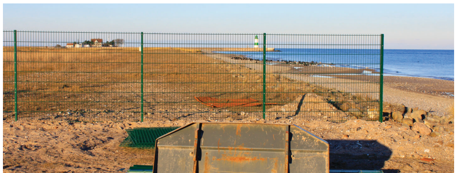
Der Bau des finalen Prädatorenzaunes im Olpenitzer Gebietsteil hat begonnen. Foto: Benjamin Burkhard
