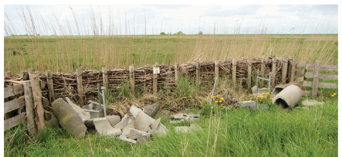
Eine der zerstörten Betonfallen im Neufelderkoog-Vorland.
